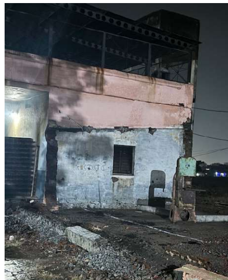
Unser Boarding-Gebäude in Sendhwa droht einzubrechen und benötigt einen Neubau.
